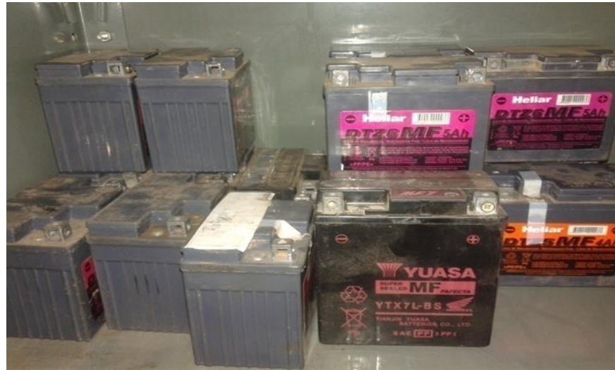
Figura 2. Acondicionamentos das Baterias usadas na Concessionária
