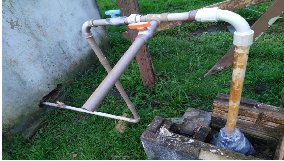
Figura 02: Saída do poço artesiano
