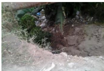
Figura. 2 Degradación. Fuente: los autores
