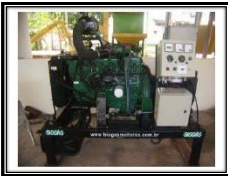
Figura 7: Gerador da marca WEG, modelo GTA162AIVD
