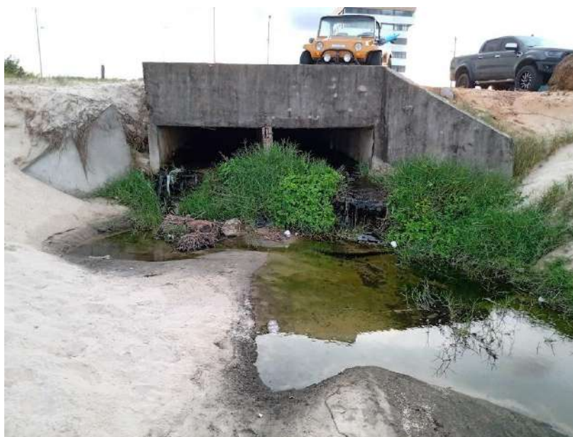
Figura 10 – Galeria presente em trecho da Praia do Futuro
