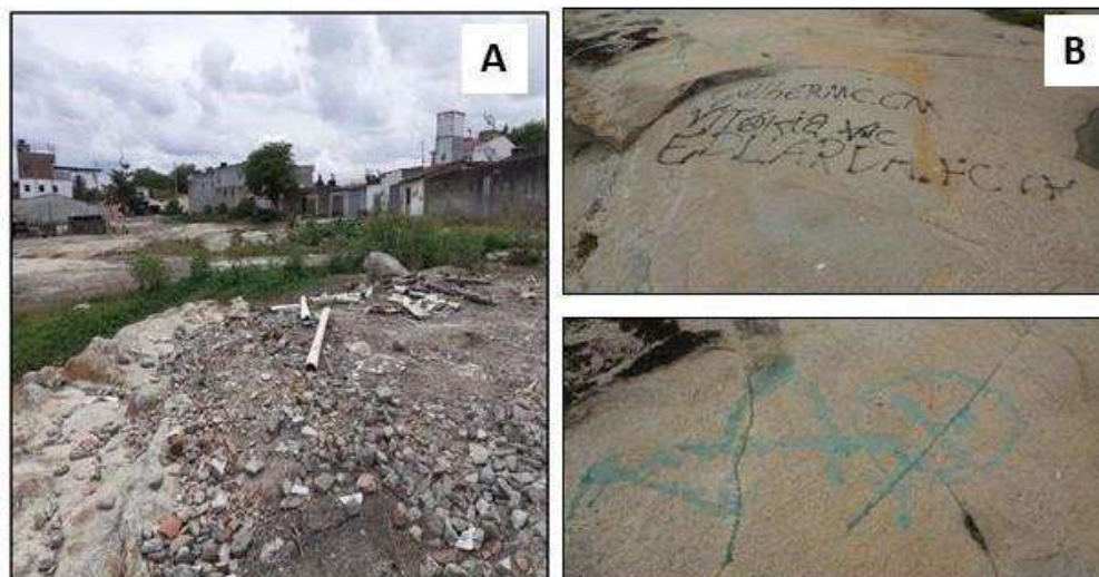
Figura 3. Registro de depósitos irregulares de resíduos sólidos e pichações sobre a estruturas dos Caldeirões, no município de Lajedo-PE.
