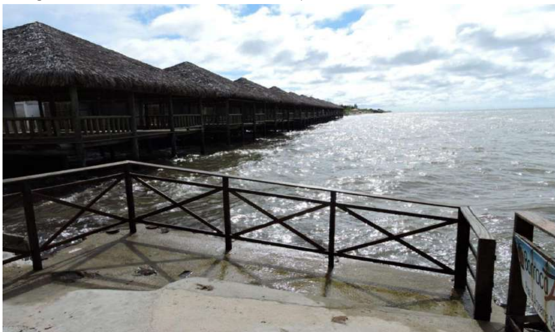
Figura 11- Base das barracas sendo atacada pelas ondas durante a maré alta.
