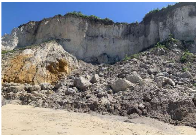
Figura 6 – Depósito de tálus.
