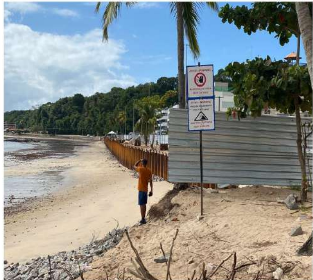
Árvores na face de praia ou com raízes expostas e infraestrutura da orla danificada pela energia das ondas.
