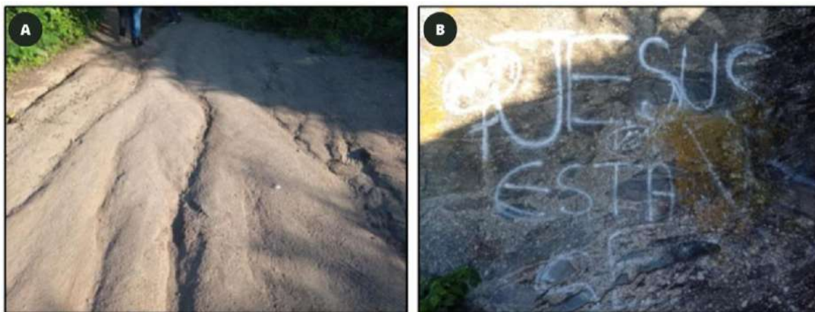
Figura 9 - A- presença de ravinas, B- Pichações no afloramento rochoso.
