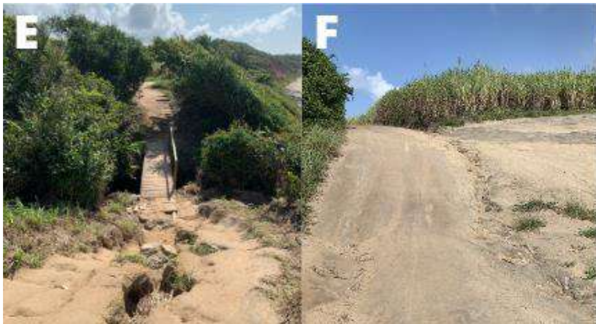
Figura 6 – Estrutura de acesso (E) e ravinamento em acesso à praia de Carra Quebrado (F).
