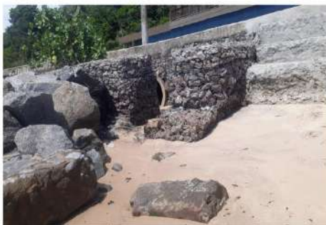
Infraestrutura da orla danificada pela energia das ondas.
