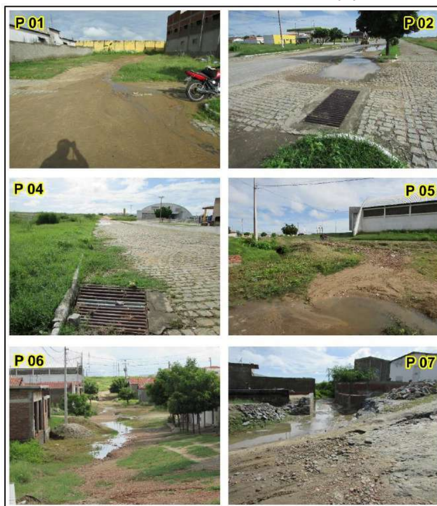
Figura 11 – Mosaico fotográfico das áreas sem infraestrutura de drenagem e pontos de alagamento na zona urbana de São Fernando – RN 2019.
