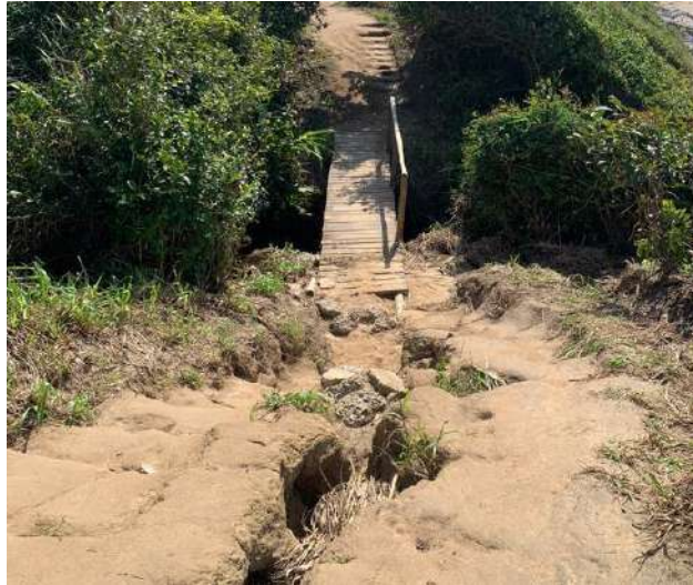
Figura 5 – Ravinamento em acesso à praia de Carra Quebrado.
