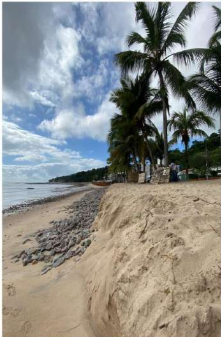
Erosão progressiva de depósitos marinhos e/ou eólicos pleistocênicos a atuais que bordeja as praias, sem o desenvolvimento de falésias (Praias urbanizadas ou não).
