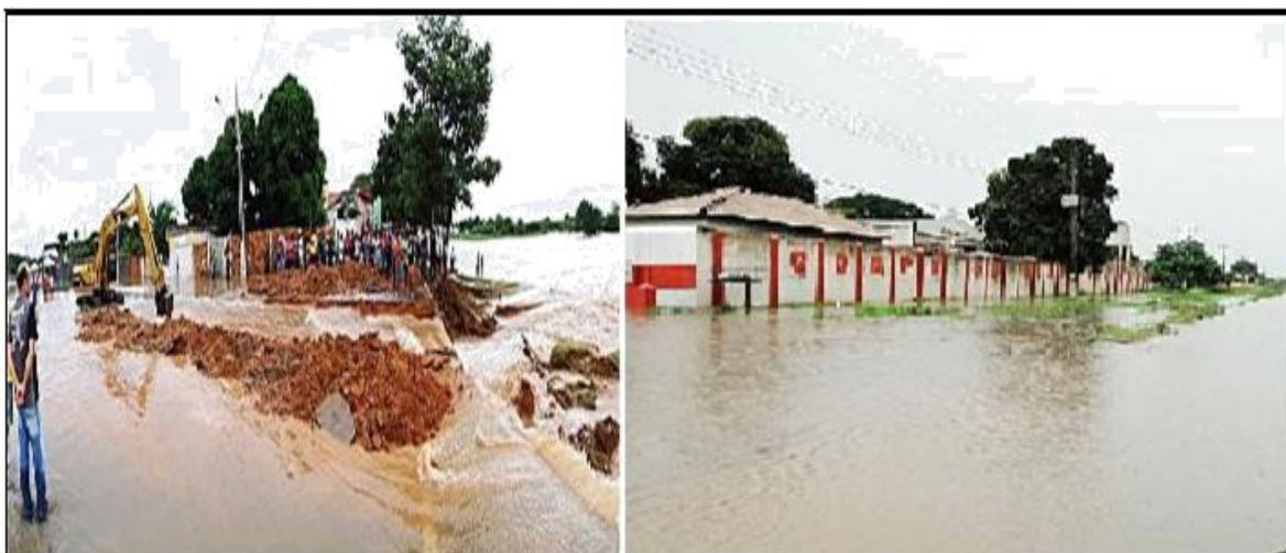
Figura 3. Alagamentos e obras para dar vazão na água 11/02, local. Centro e bairro, DNER Fonte: Cáceres. mt, 2010
