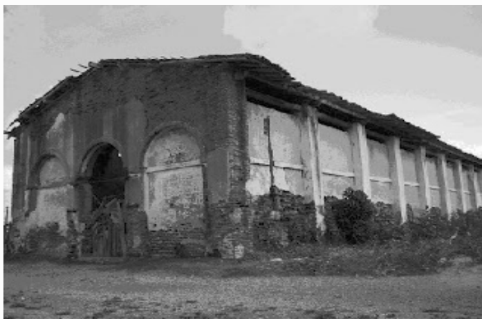
Figura 52. Ruínas do parque ferroviário de Camocim. Fonte: Estações Ferroviárias do Ceará.
