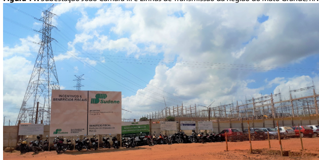
Figura 11: Subestação João Câmara III e Linhas de Transmissão da Região do Mato Grande/RN
