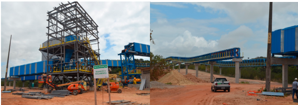
Figura 15 – Ampliação da correia transportadora em dois ângulos na área do CIPP
