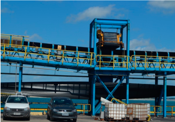
Figura 13 – Torre de comando da correia transportadora no terminal 1
